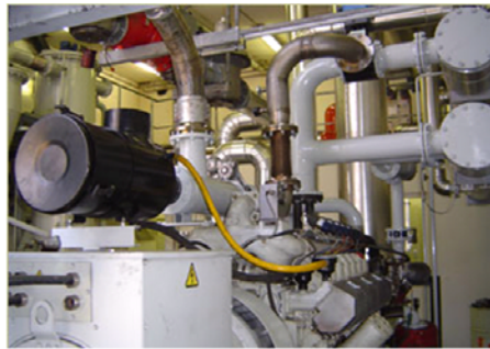
BHKW-Anlage im Schwimmbad, Foto: Schmidt 2008
